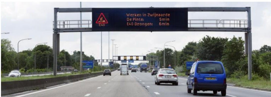
Figuur 23: Dynamische signalisatie E40 Zwijnaarde (Bron: AWV)
