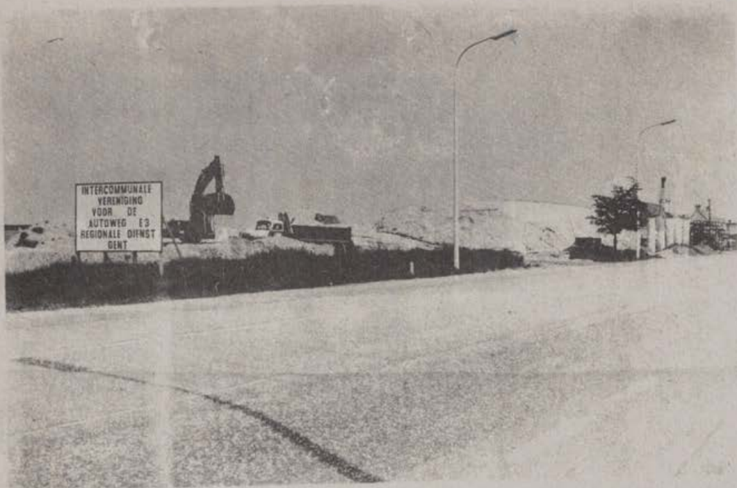
De werken aan de viaduct over de RW14, in een vroeg stadium.
